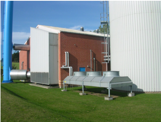
Abbildung 4.3: Tischkühler an einer KWK-Anlage
