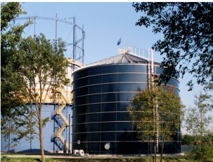
Abbildung 4.4: Biogas-Speicher am GOS Klärwerk
